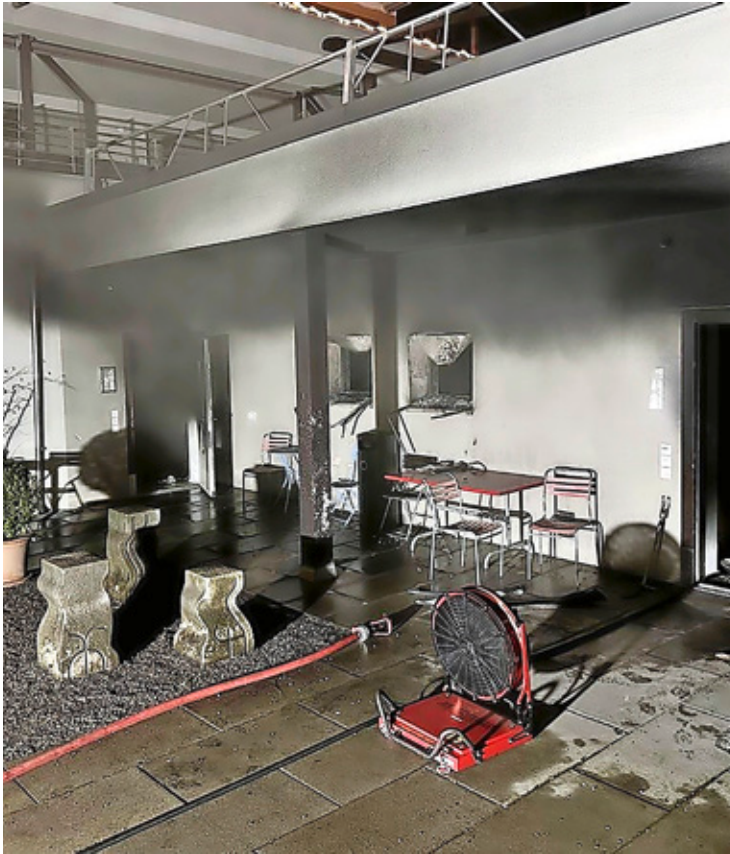
Die vom Brand betroffenen Räume sind derzeit nicht mehr bewohnbar.
