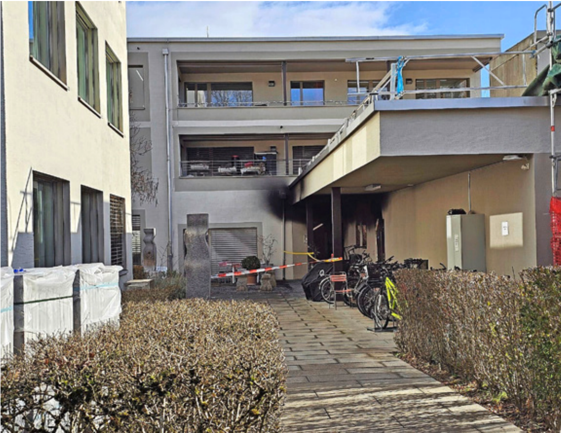
Die vom Brand betroffene Wohneinheit ist abgesperrt und weist sichtbare Spuren auf. Foto: Marie Fredericq
